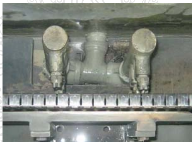
ภาพที่ 4.10 Nozzle ใน Hi Pressure Water Cell
