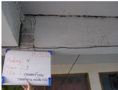
รูปที่ NRN 4/3-03 : ปัญหาการแตกร้าวและการหลุดล่อนของชั้นปูนฉาบบริเวณส่วนต่อคาน (อาคาร 4 หน้าห้อง 51/64)
