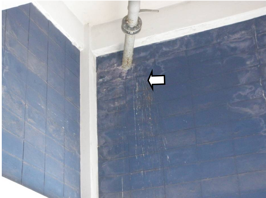
รูปที่ 4.33 ปัญหาคราบไล่น้ำที่รั่วซึมบริเวณผนังโถงบันได (อาคาร 5)
