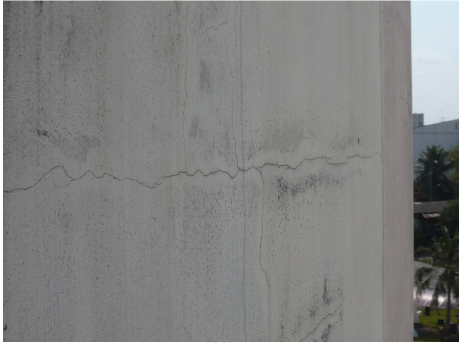
รูปที่ 4.58 ปัญหารอยร้าวผนังด้านนอกอาคารบริเวณบันไดทิศตะวันตก (อาคาร 11 ชั้น 5)
