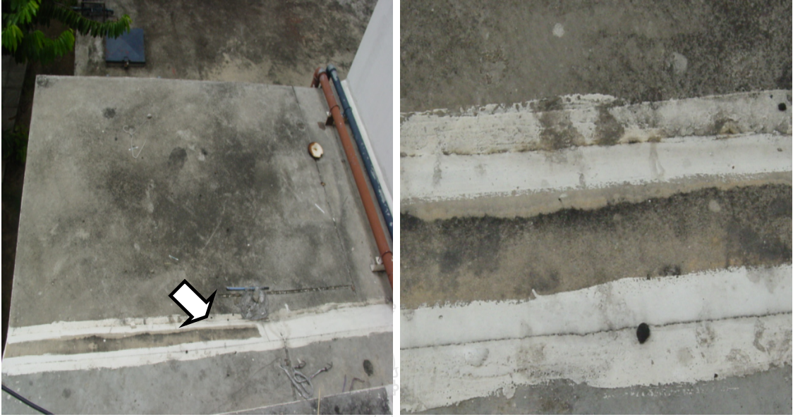
รูปที่ 4.22 ปัญหาหลังคาห้องปั้มน้ำเกิดรอยร้าวและมีน้ำรั่วซึม (อาคาร 22)
