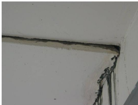
รูปที่ RNG 17/5 - 01 : ปัญหารอยต่อบริเวณเพดานโถงบันไดชั้นตาดฟ้าลง ชั้น 5มีการทรุดตัว เกิดรอยร้าว(อาคาร 17)
