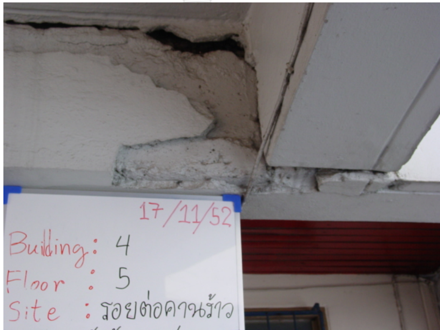
รูปที่ 4.27 ปัญหาการแตกร้าวและการหลุดร่อนของชั้นปูนฉาบบริเวณส่วนต่อคาน (อาคาร 4 หน้าห้อง 51/148)
