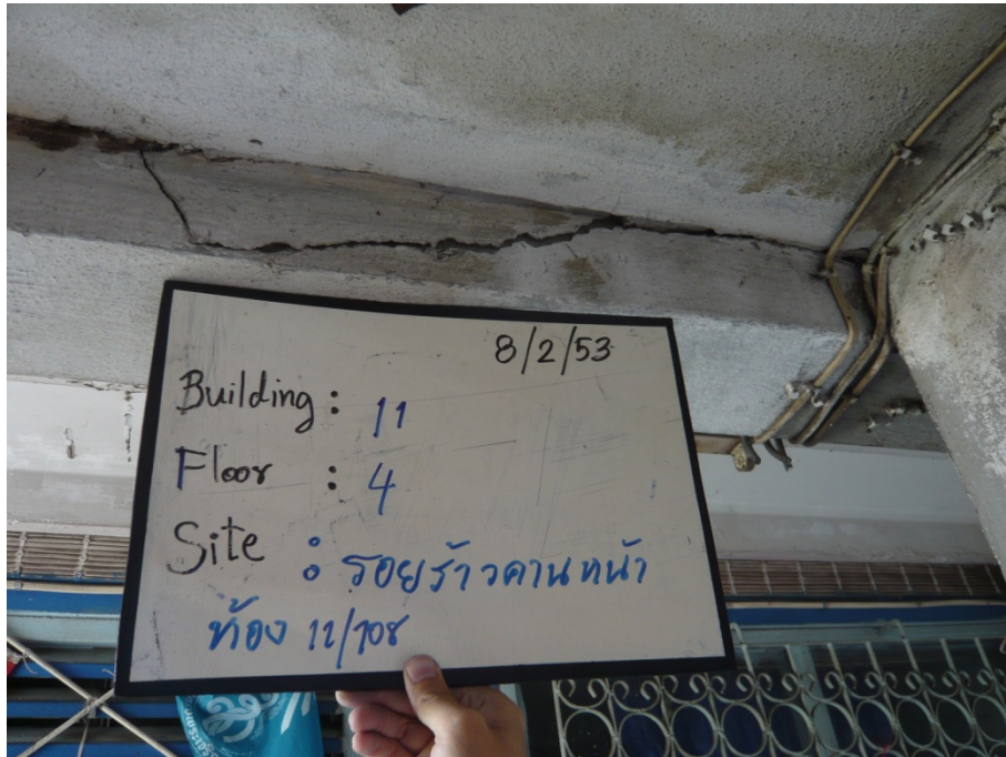
รูปที่ 4.52 ปัญหาคานเกิดรอยร้าว (อาคาร 11 หน้าห้อง 11/108)
