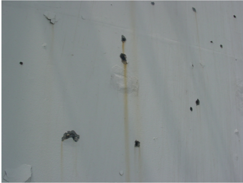
รูปที่ 4.8 ปัญหาเกิดรอยสนิมที่ผนังด้านนอกอาคาร (อาคาร 44)
