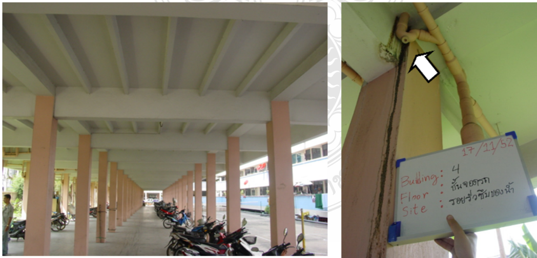
รูปที่ 4.29 ปัญหาน้ำรั่วซึมทางเดินท่อใต้อาคาร (อาคาร 4)
