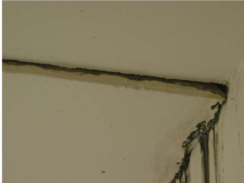
รูปที่ 4.7 ปัญหารอยต่อบริเวณเพดาน โถงบันไดชั้นดาดฟ้าลงชั้น 5 มีการทรุดตัว เกิดรอยร้าว(อาคาร 17)
