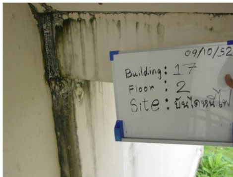
รูปที่ RNG 17/2 - 02 : ปัญหารอยต่อบริเวณบันไดหนีไฟมีรอยรั่ว อาคาร 17
