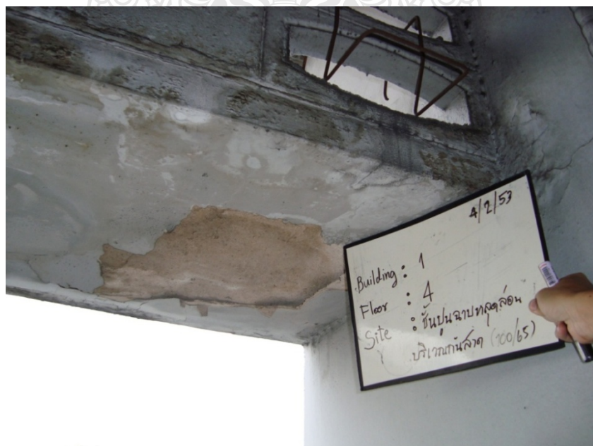
รูปที่ 4.42 ปัญหาชั้นปูนฉาบหลุดร่อนบริเวณกันสาด (อาคาร 1 หน้าห้อง 100/65)
