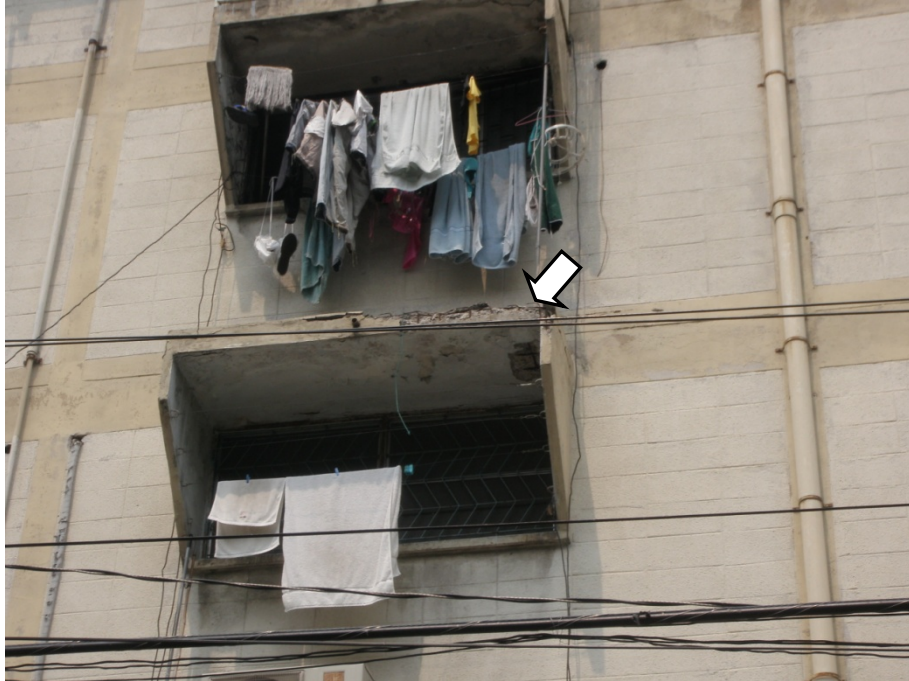
รูปที่ 4.51 ปัญหากันสาดที่หน้าต่างเกิดการกะเทาะเห็นเหล็กเสริมเกิดสนิม (อาคาร 1)
