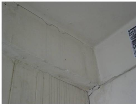
รูปที่ RNG 17/2 - 01 : ปัญหาการรั่วซึมรอยต่อบริเวณผนังบริเวณโถงบันได ชั้น 2 ลงชั้น 1 (อาคาร 38)
