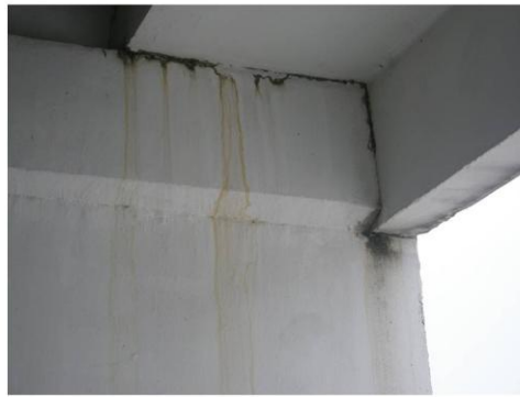
รูปที่ RNG 38/5 - 01 : ปัญหาการรั่วซึมรอยต่อบริเวณผนังบริเวณโถงบันได ชั้น 5 ลงชั้น 4 (อาคาร 38)
