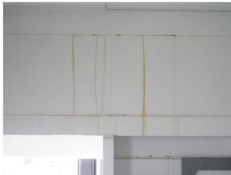
รูปที่ RNG 38/5 - 02 : ปัญหาการรั่วซึมรอยต่อบริเวณผนังบริเวณโถงบันได ชั้น 5 ลงชั้น 4 (อาคาร 38)
