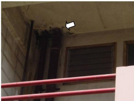
รูปที่ NRN 2/1-02 : ปัญหาหัวรั้วซึมทางเดินที่บริเวณชานพักหลังห้องครัว (อาคาร 2)
