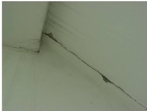
รูปที่ RNG 38/3 - 02a : ปัญหารอยต่อบริเวณบันไดหนีไฟมีรอยร้าว อาคาร 38
