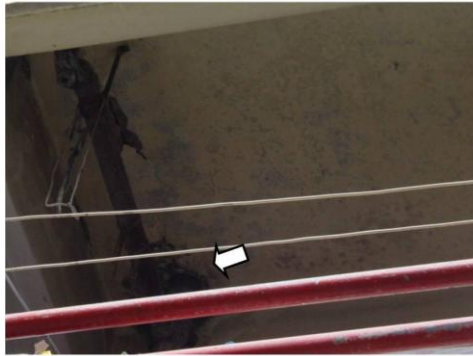
รูปที่ NRN 2/1-01 : ปัญหาหัวรั้วซึมทางเดินที่บริเวณชานพักหลังห้องครัว (อาคาร 2)
