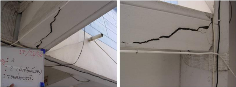
รูปที่ NRN 3/2-01 : ปัญหาคานเกิดรอยแตกร้าว (อาคาร 3 ชั้น 2)
