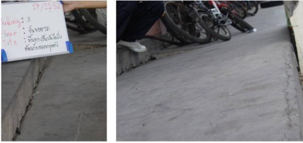
รูปที่ NRN 3/1-02 : ปัญหาพื้นทางเดินชั้นบนได้ฝั่งห้องเก็บของทรุดตัว (อาคาร 3 ชั้นจอดรอก)
