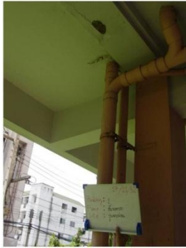
รูปที่ NRN 2/1-03 : ปัญหาปูนฉาบล่อนบริเวณคานชั้นจอดรถ ( อาคาร 2)
