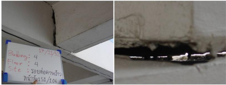
รูปที่ NRN 4/4-03 : ปัญหาการแตกร้าวและการหลุดล่อนของชั้นปูนฉาบบริเวณส่วนต่อคาน (อาคาร 4 หน้าห้อง 51/106)
