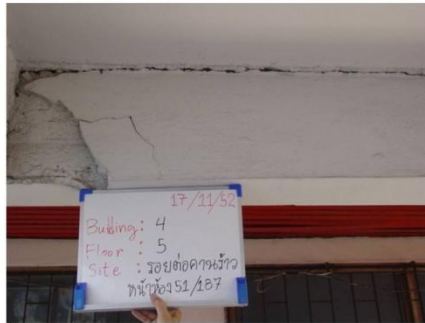
รูปที่ NRN 4/5-01 : ปัญหาการแตกร้าวและการหลุดล่อนของชั้นปูนฉาบ บริเวณส่วนต่อคาน (อาคาร 4 หน้าห้อง 51/187)
