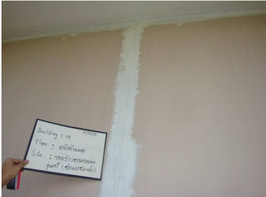
รูปที่ 4.26 ปัญหารอยร้าวระหว่างรอยต่อผนังด้านนอก (มีการซ่อมแซมแล้ว) (อาคาร19)
