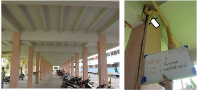
รูปที่ NRN 4/1-02 : ปัญหาน้ำรั่วซึมทางเดินท่อใต้อาคาร (อาคาร 4)
