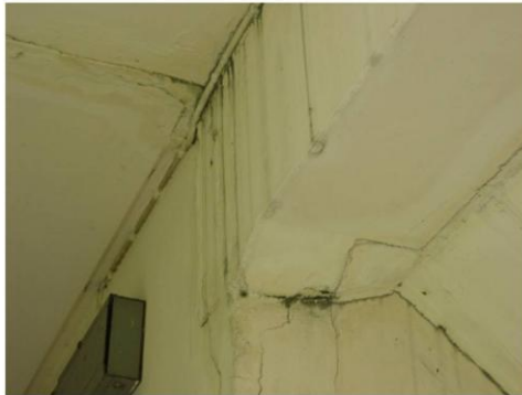
รูปที่ RNG 17/2 - 02a : ปัญหารอยต่อบริเวณบันไดหนีไฟมีรอยร้าว อาคาร 17
