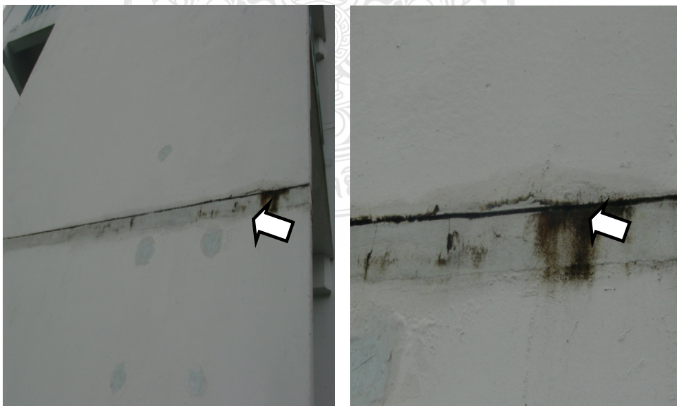
รูปที่ 4.13 ปัญหาเกิดรอยร้าวตามรอยต่อผนังรับบันไดหนีไฟ (อาคาร 117)
