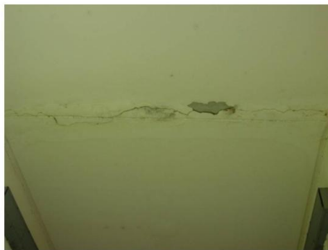
รูปที่ RNG 17/1 - 02 : ปัญหารอยต่อระหว่างเพดานชั้น 2 และผนังห้อง เกิดรอยร้าวและมีน้ำรั่วซึม อาคาร 17
