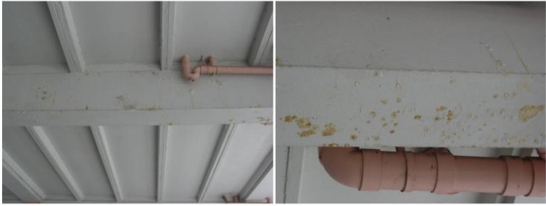
รูปที่ NRN 3/1-03: ปัญหาฝ้ารื้อซึม (อาคาร 3)
