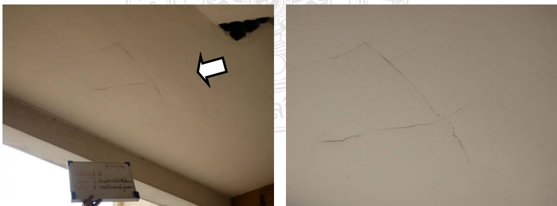
รูปที่ 4.35 ปัญหารอยร้าวชั้นปูนฉาบบริเวณเพดานชานพักบันไดขึ้นชั้น 4 (อาคาร 9)
