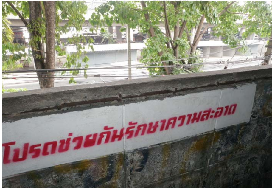
รูปที่ 4.50 ปัญหาทับหลังกำแพงทางเดินกะเทาะเห็นเหล็กเสริมขึ้นสนิม (อาคาร 9 ชั้น 2 ฝั่งบันไดตะวันตก)
