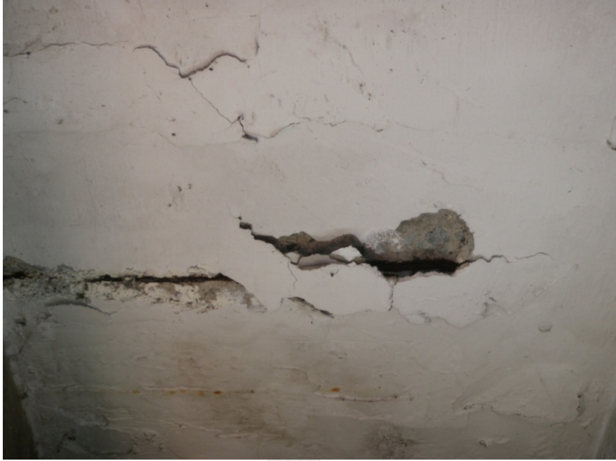
รูปที่ 4.47 ปัญหาท้องพื้นชั้น 5 กะเทาะเห็นเหล็กเสริมเกิดสนิม (อาคาร 1 หน้าห้อง 135/203)
