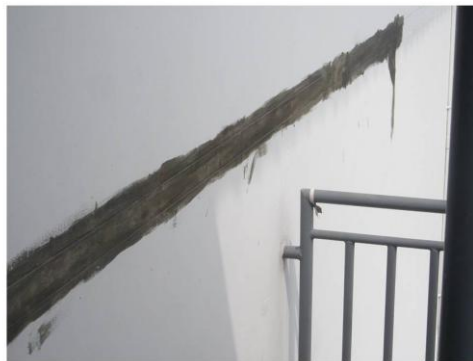
รูปที่ RNG 38/5 - 04 : ปัญหารอยต่อบริเวณกำแพงภายนอกอาคารชั้น 5 ลง ชั้น 4 บริเวณบันไดหนีไฟเกิดรอยร้าว (อาคาร 38)
