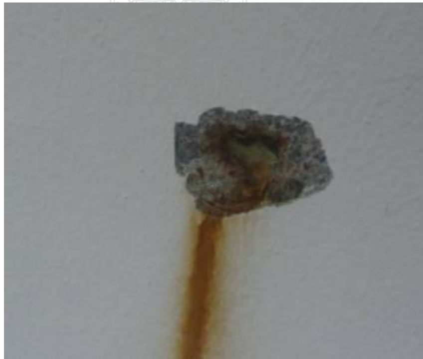
รูปที่ 4.21 ปัญหาการเกิดปฏิกิริยาไฟไรต์ (อาคาร 22)
