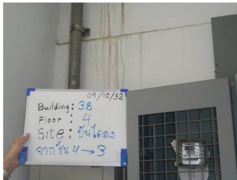
รูปที่ RNG 38/4 - 02 : ปัญหาการรื้อซึมรอยต่อบริเวณผนังบริเวณโถงบันได ชั้น 4ลงชั้น 3 (อาคาร 38)
