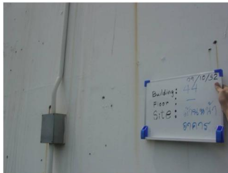
รูปที่ RNG 44/1-5 - 01 : ปัญหาเกิดรอยสนิมที่ผนังด้านนอกอาคาร (อาคาร 44)
