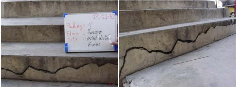
รูปที่ NRN 4/1-01 : ปัญหารอยร้าวการทรุดตัวของทางเดินบันได (อาคาร 4)
