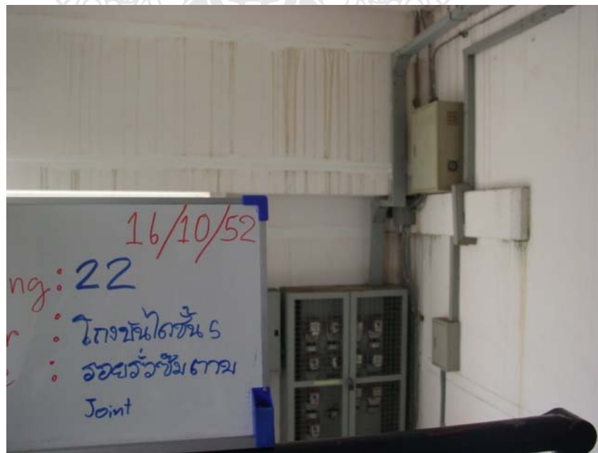
รูปที่ 4.18 ปัญหาการร้าวซึมรอยต่อผนังบริเวณ โถงบันไดชั้น 5 ลงชั้น 4 (อาคาร 22)
