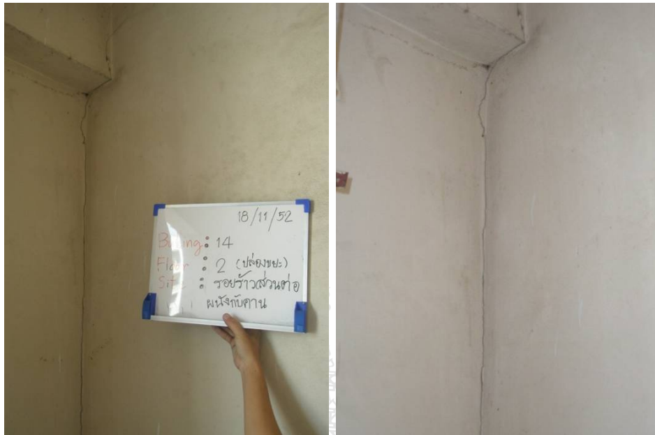
รูปที่ 4.36 ปัญหา รอยร้าวมุมผนังบริเวณปล่องขยะ (อาคาร 14)
