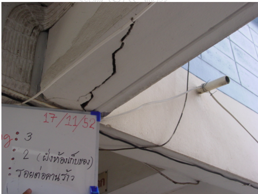
รูปที่ 4.31 ปัญหาคานเกิดรอยแตกร้าว (อาคาร 3 ชั้น 2)
