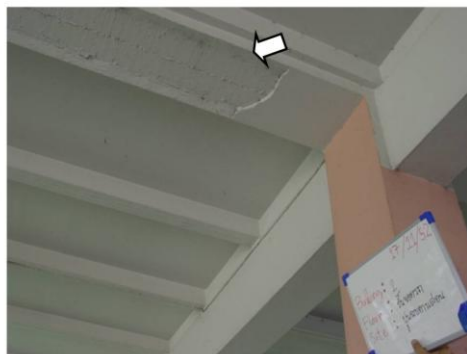
รูปที่ NRN 2/1-02 : ปัญหาปูนฉาบล่อนบริเวณคานชั้นจตุรภุม (อาคาร 2)
