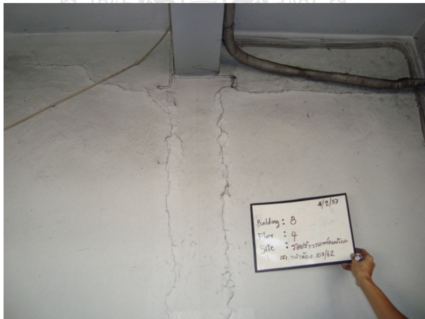
รูปที่ 4.44 ปัญหาผนังปูนฉาบเกิดรอยร้าว (อาคาร 8 ชั้น 4 หน้าห้อง 107/62)
