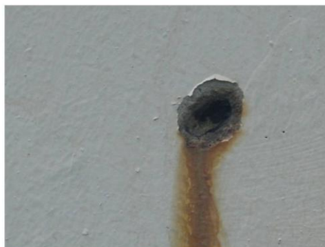
รูปที่ RNG 44/1-5 - 01a : ปัญหาเกิดรอยสนิมที่ผนังด้านนอกอาคาร (อาคาร 44)
