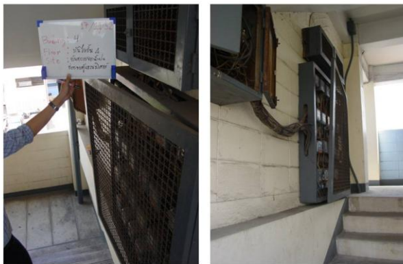
รูปที่ NRN 4/4-02 : ปัญหาอันตรายจากน้ำฝนที่มากกระทบตู้มิเตอร์ไฟฟ้า (อาคาร 4)
