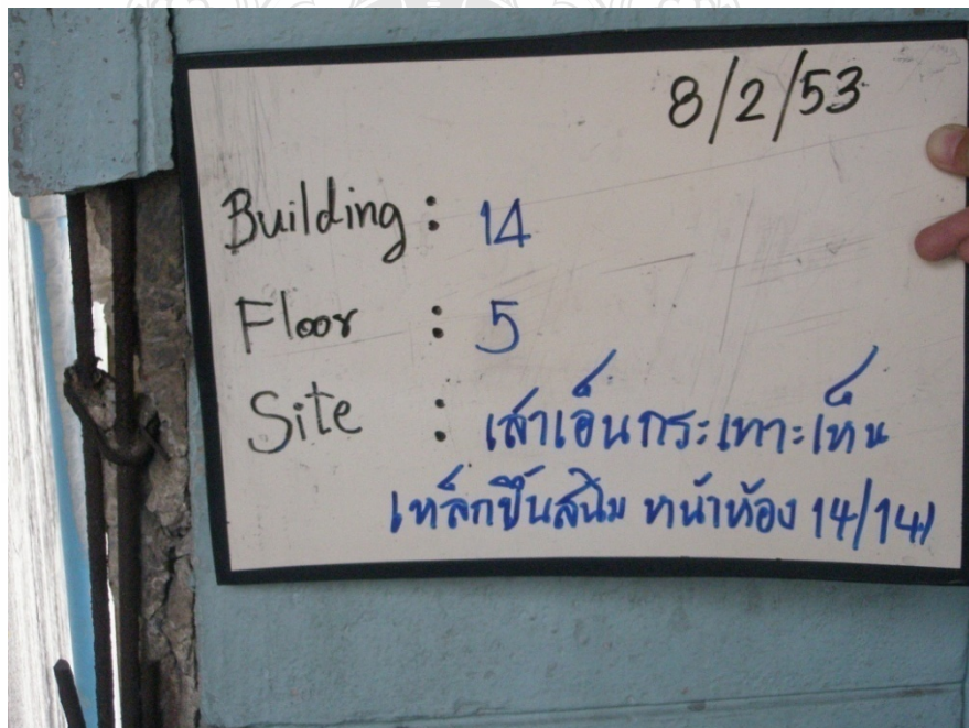
รูปที่ 4.54 ปัญหาเสาเอ็นกะเทาะเห็นเหล็กเสริม(อาคาร 14 หน้าห้อง 14/141)
