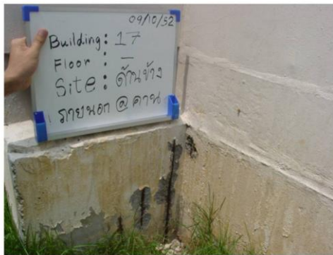
รูปที่ RNG 17/1 - 04 : มีการกะเทาะของผิวคอนกรีตที่คานคอดิน (อาคาร 17)
