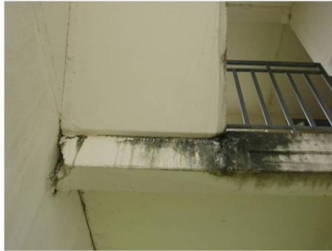
รูปที่ RNG 17/1 - 03 : ปัญหารอยต่อบริเวณบันไดหนีไฟมีรอยร้าว อาคาร 17
