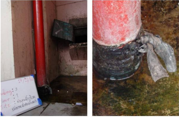
รูปที่ NRN 3/1-01 : ปัญหาที่อเมหน้าบริเวณปล่องขยะฝั่งห้องเก็บของมีรอยรั่วซึม (อาคาร 3 ชั้น 1)
