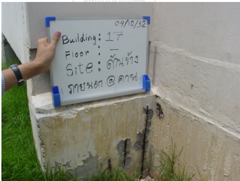
รูปที่ 4.9 มีการกะเทาะของผิวคอนกรีตที่คานคอดิน (อาคาร 17)
