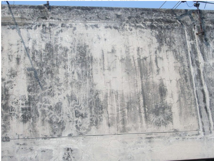
รูปที่ 4.59 ปัญหาผนังปูนฉาบเกิดรอยร้าวแตกถายงา (อาคาร 18)
