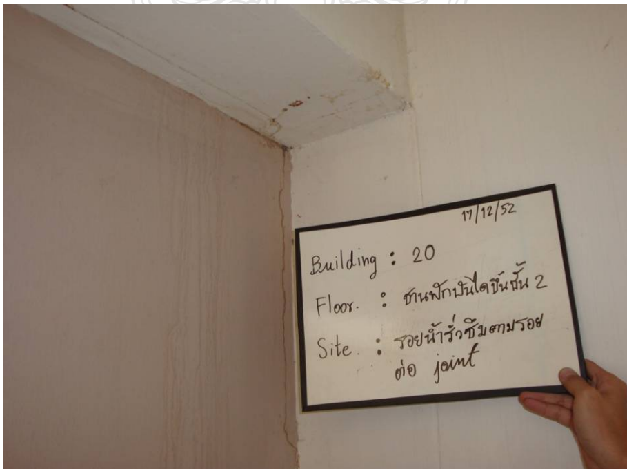
รูปที่ 4.25 ปัญหาการรั่วซึมตาม joint บริเวณชานพักบันไดขึ้นชั้น 2 (อาคาร 20)
