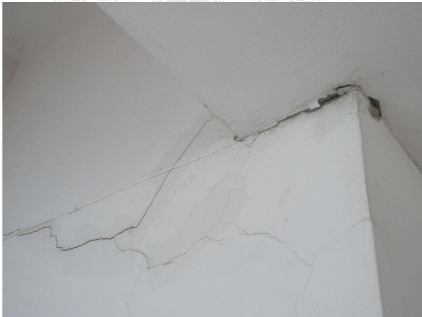
รูปที่ 4.62 ปัญหารอยร้าวช่องงานระบบหน้าห้อง 450/553 (อาคาร A ชั้น 19)
