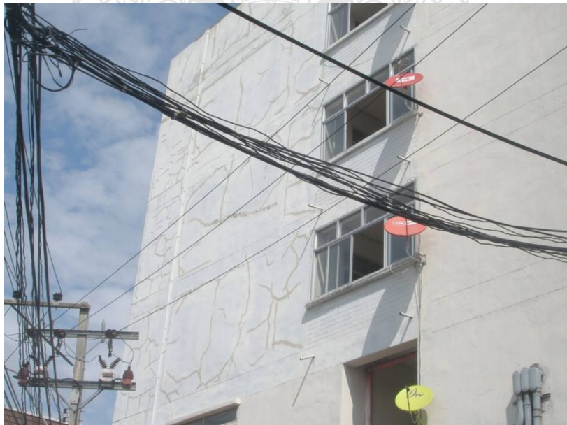
รูปที่ 4.39 ปัญหาผนังด้านนอกเกิดรอยแตกถายางของชั้นปูนฉาบ (อาคาร 14)
