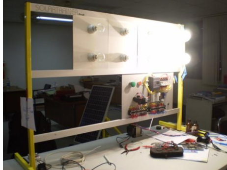
รูปที่ 3.26 การติดตั้งโหลดและทดสอบชุดควบคุม
