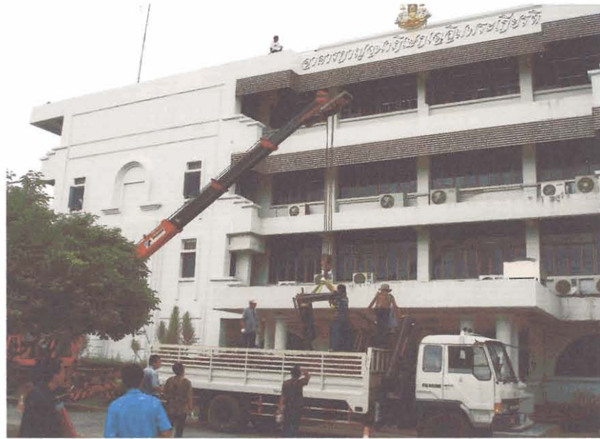
ภาพที่ 3.23 เคลื่อนย้ายชิ้นส่วนต่างๆ ของโดมสู่คานฟ้าของอาคารที่ติดตั้ง
