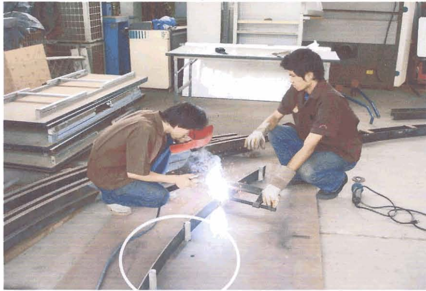
ภาพที่ 3.11 การเชื่อมจิกเพื่อตัดโค้งเหล็กตัวราง
