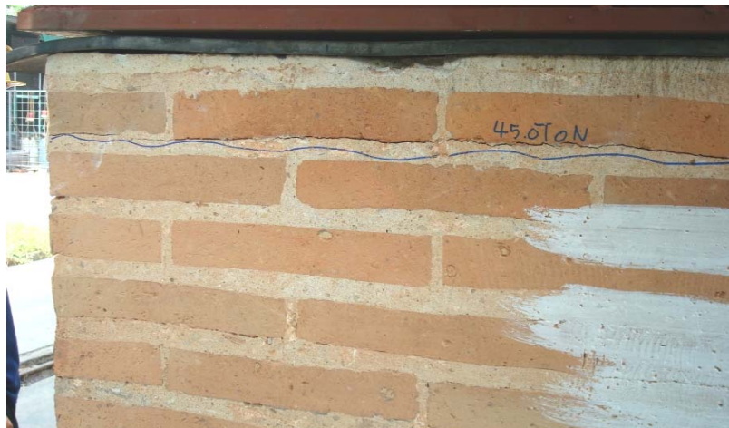
รูปที่ 4.9 ตัวอย่างการ Crack ของผนังเปล่า 1
