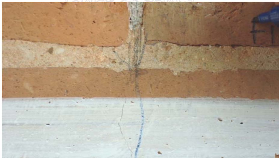
รูปที่ 4.12 ตัวอย่างการ crack ของผนังเปล่า 2
