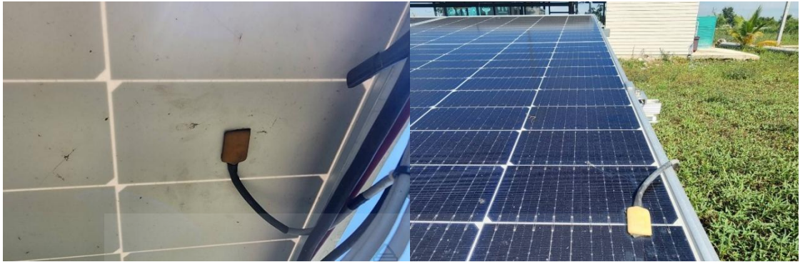
รูปที่ 3.5 การติดตั้งเซ็นเซอร์วัดอุณหภูมิพื้นผิว ยี่ห้อ LSI LASTEM รุ่น DLE124
