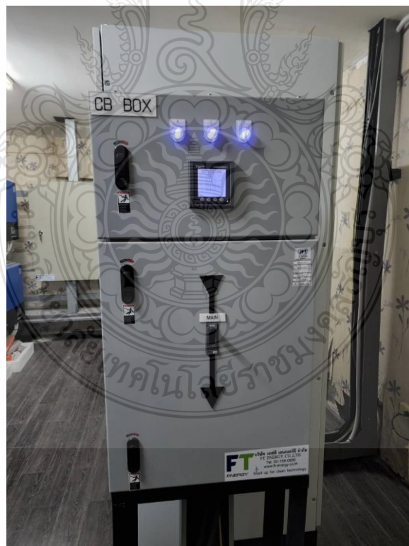
รูปที่ 3.21 ตู้เบรกเกอร์วงจรไฟฟ้า
