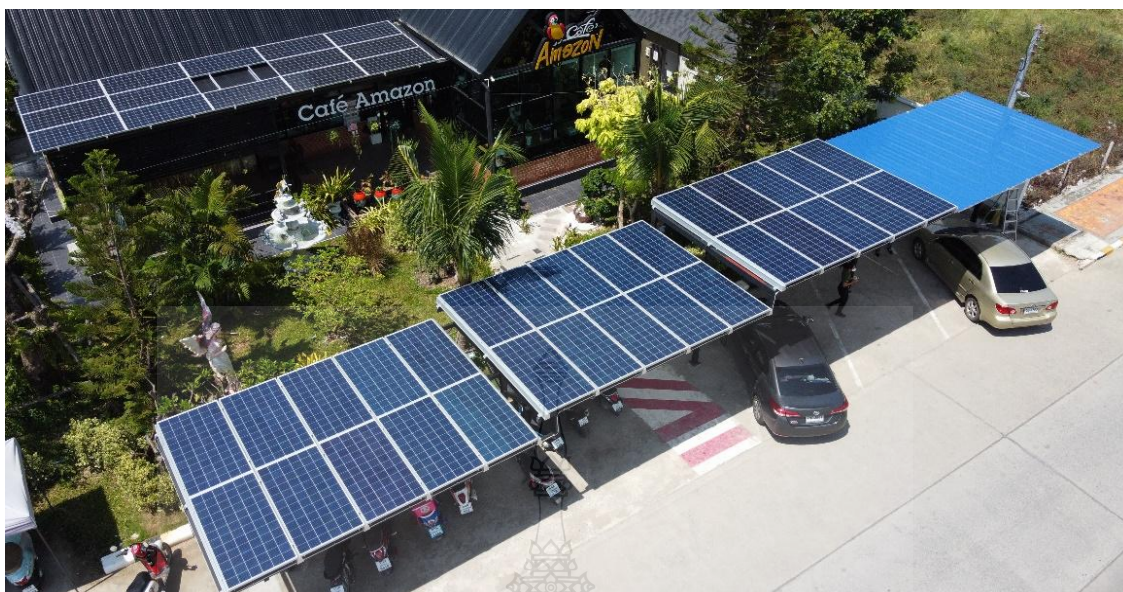
รูปที่ 3.13 การติดตั้งเซลล์แสงอาทิตย์บนหลังคาอาคารจอดรถ ที่ระดับความสูง 2.5 เมตร 3 เมตร และ 3.5 เมตร จากพื้นดิน
