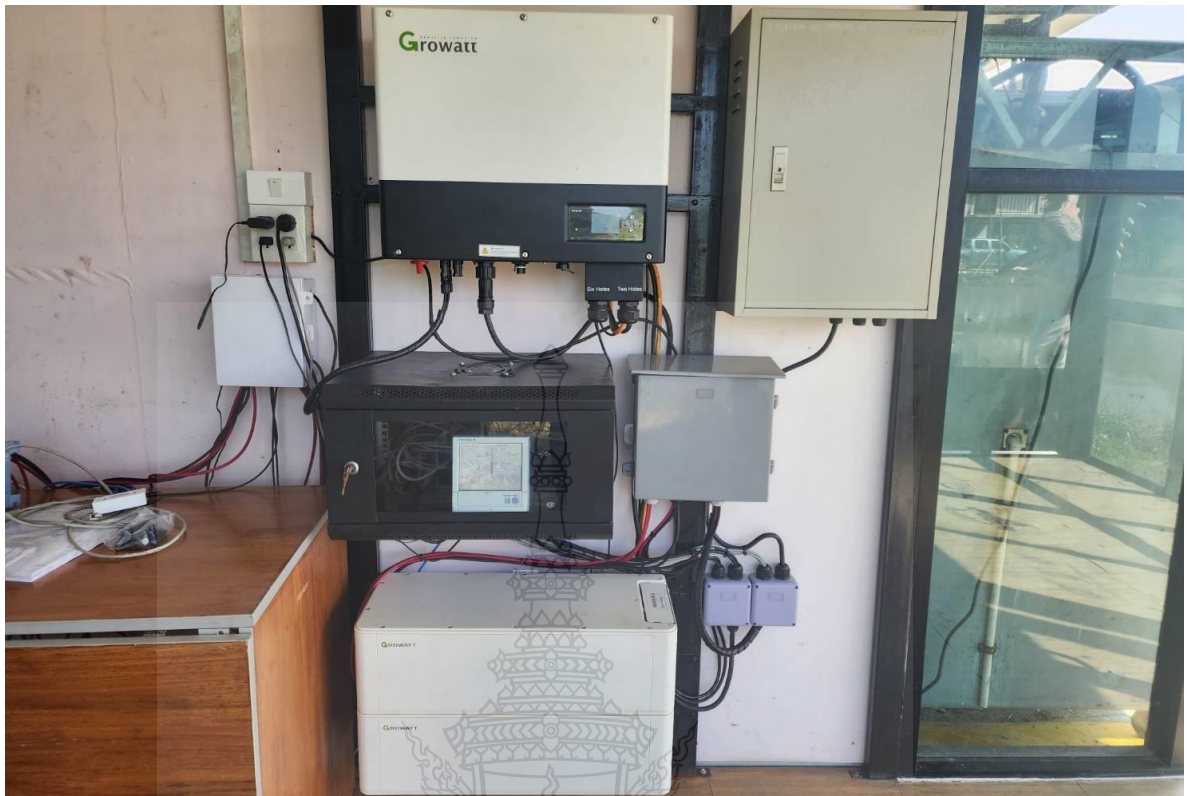
รูปที่ 3.3 การติดตั้งอินเวอร์เตอร์ พร้อมทั้งแบตเตอรี่ ยี่ห้อ Growatt
