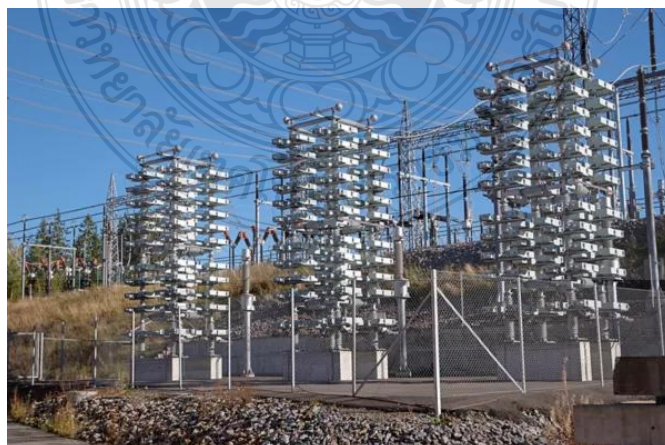
รูปที่ 1.1 ชุดอุปกรณ์คาปาซิเตอร์แรงดันสูงในสถานีย่อย [1]
