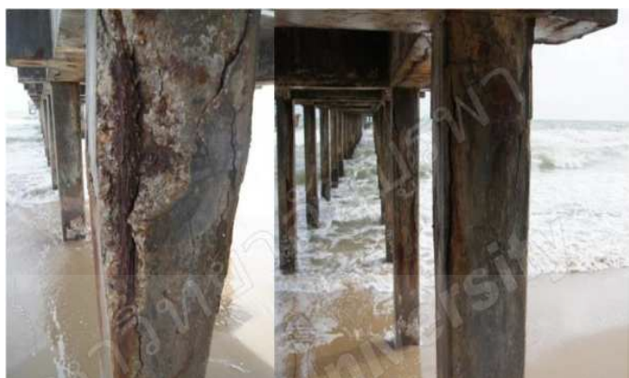
รูปที่ 2.8 ความเสียหายของคอนกรีตเสริมเหล็กเนื่องจากคลอไรด์โดยเหล็กเป็นสนิมดันคอนกรีตให้แตกร้าว หรือหลุดร่อนออกมา [1]
