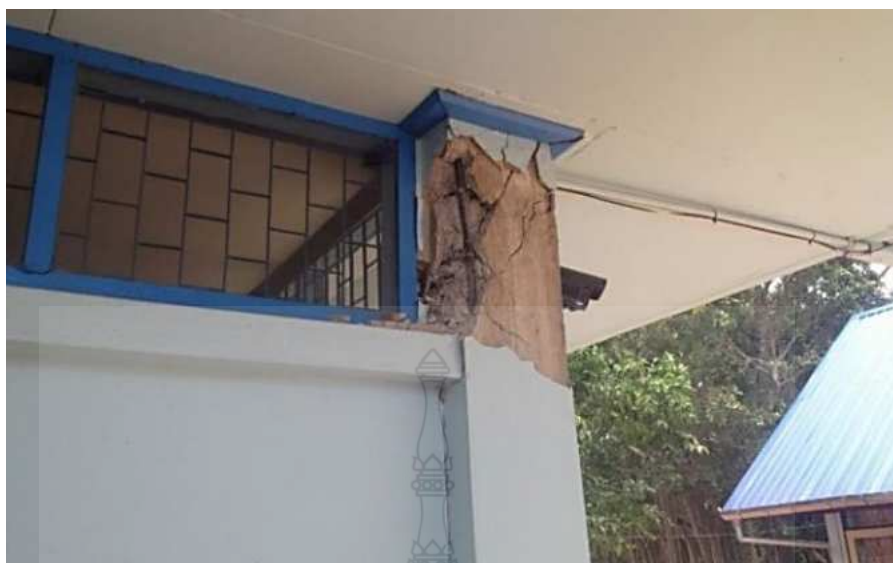
รูปที่ 2.1 การวิบัติของเสาจากผลของผนังอิฐก่อ
