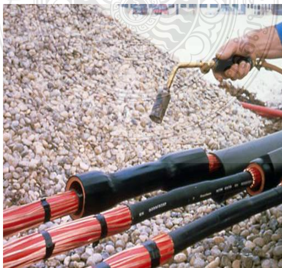
รูปที่ 2.4 แสดงตัวอย่างการต่อสายเคเบิลใต้ดินแบบ Heat Shrink Type[14]
