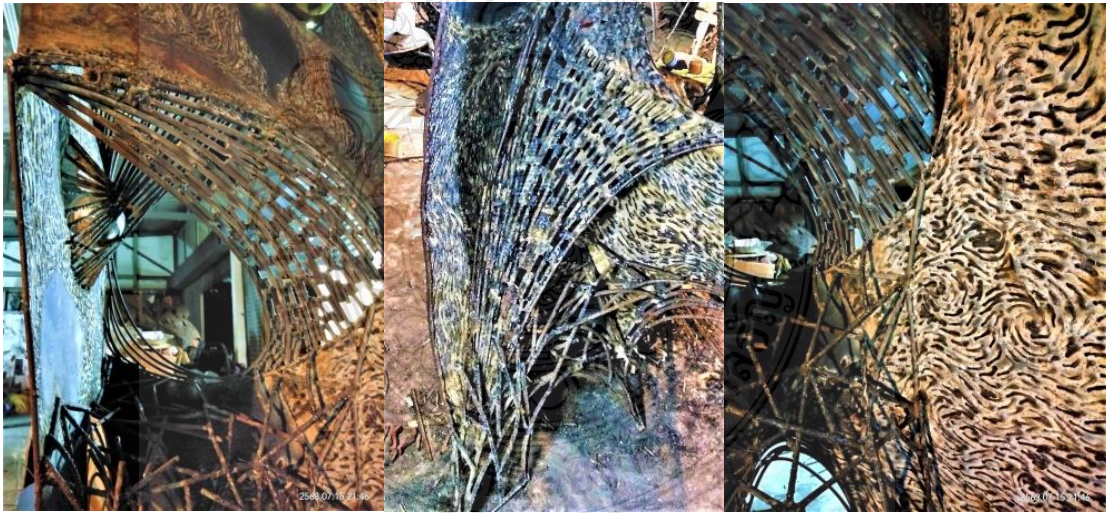
ภาพที่ 3.160 แสดงเหล็กโครงสร้าง และเหล็กเส้นที่เป็นส่วนประกอบของรูปทรงผลงานชิ้นที่ 3
