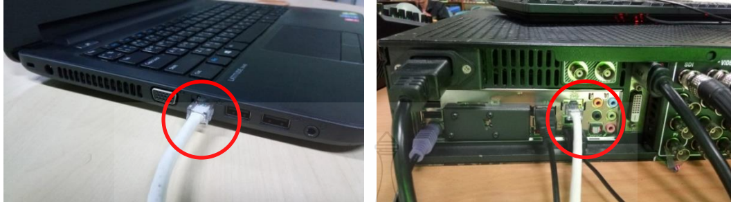
ภาพที่ 4-54 การต่อสายสัญญาณต่ออินเทอร์เน็ตที่เครื่องคอมพิวเตอร์และเครื่อง Switcher
