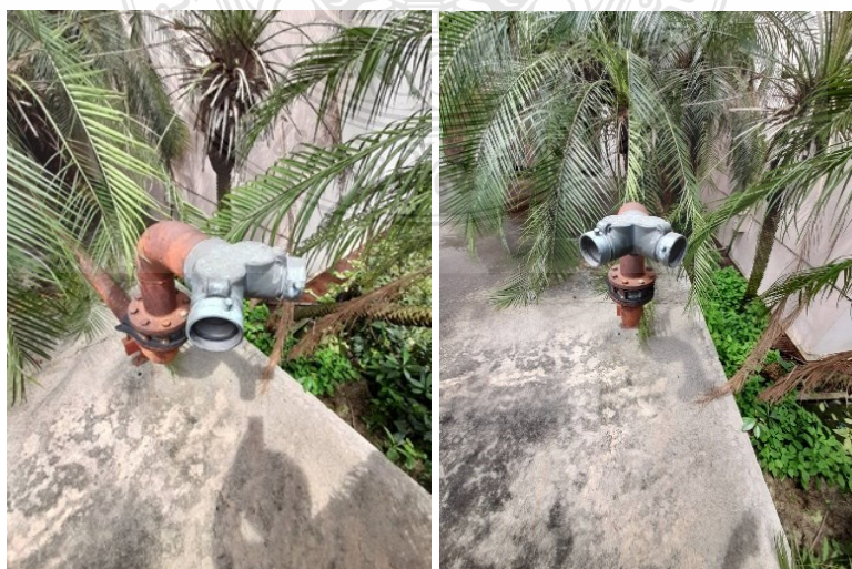
ภาพที่ 3.10 แสดงหัวจ่ายน้ำดับเพลิงสำหรับรถดับเพลิง
