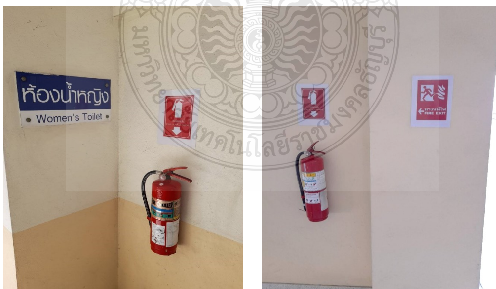
ภาพที่ 3.15 แสดงตำแหน่งติดตั้งถังดับเพลิงแบบมือถือ
