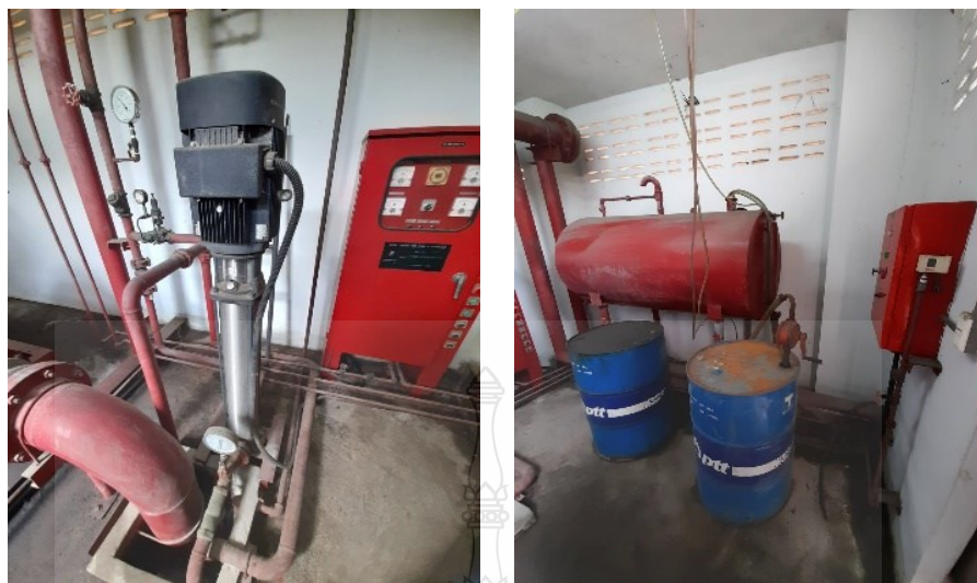
ภาพที่ 3.12 แสดงระบบปั้มน้ำสำหรับดับเพลิง (ต่อ)
