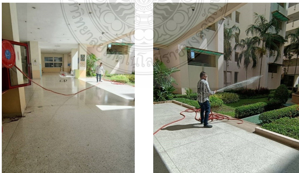
ภาพที่ 4.31 แสดงสาธิตการตรวจสอบสายฉีดน้ำดับเพลิงภายในตู้ดับเพลิง
