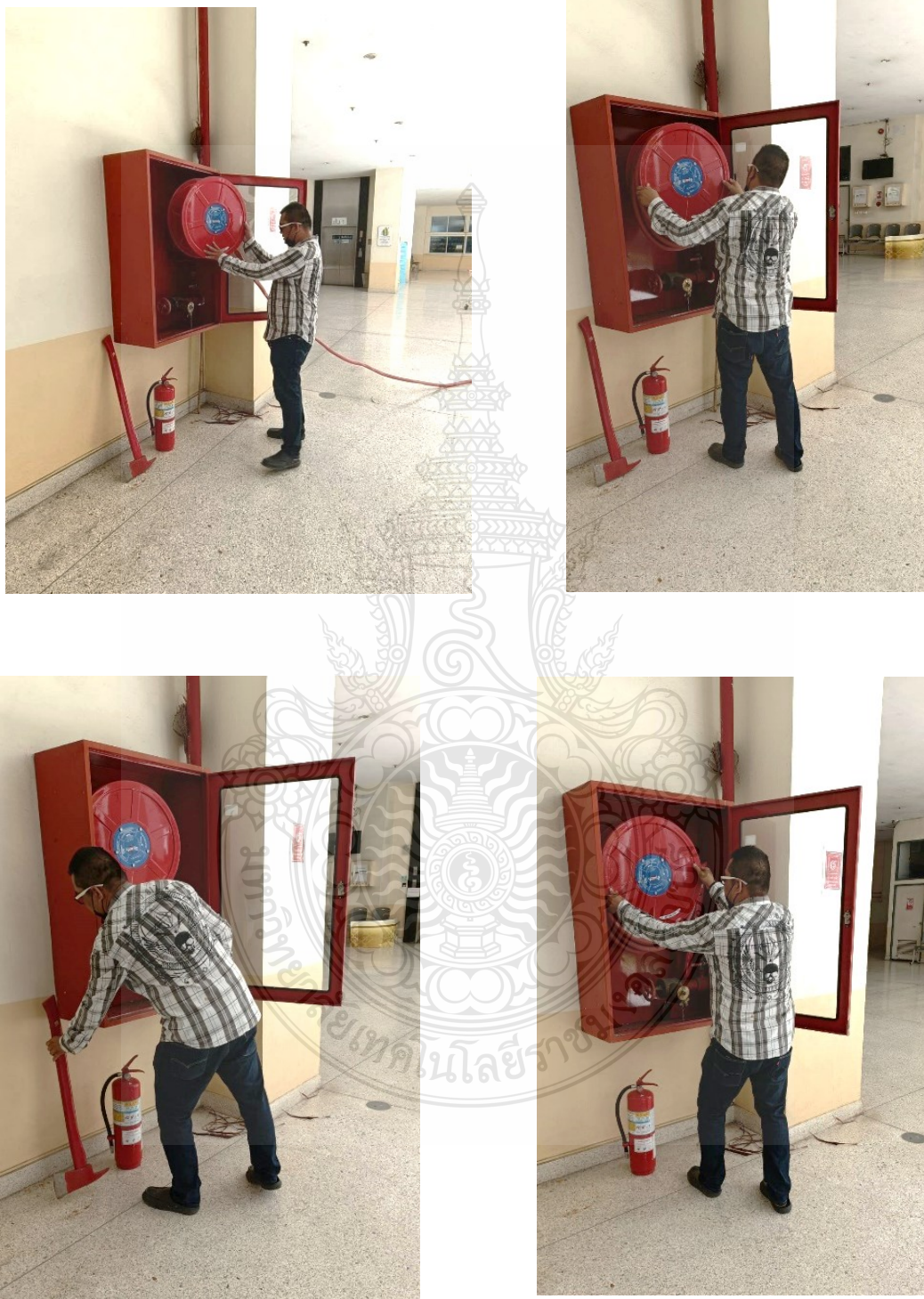
ภาพที่ 4.32 แสดงการตรวจสอบอุปกรณ์อื่น ๆ ภายในตู้ดับเพลิง
