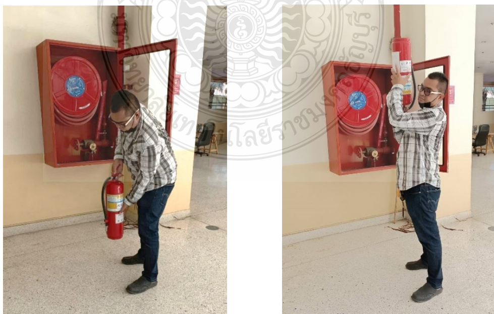
ภาพที่ 4.29 แสดงสาธิตการตรวจสอบถังดับเพลิงแบบมือถือ
