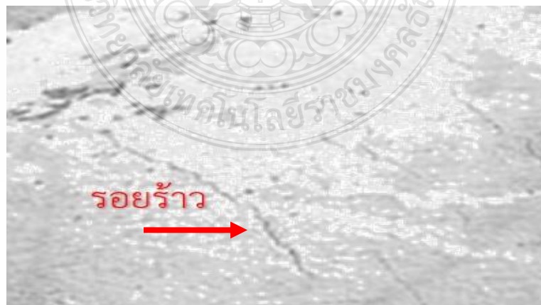
รูปที่ 2.18 รอยร้าวของคอนกรีต [22]
