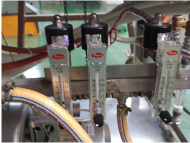
รูปที่ ค.13 การติดตั้งระบบป้อนแก๊สแยก 3 ช่องทาง
