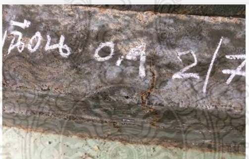
รูปที่ 3.26 การวิบัติเนื่องจากแรงเฉือน
