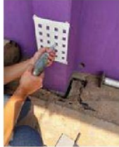
ภาพที่ 2 วิธีการทดสอบ กำลังอัด ประลัยของ โครงสร้างคอนกรีต โดยใช้ ค้อนกระแทกแบบชนิดดี
