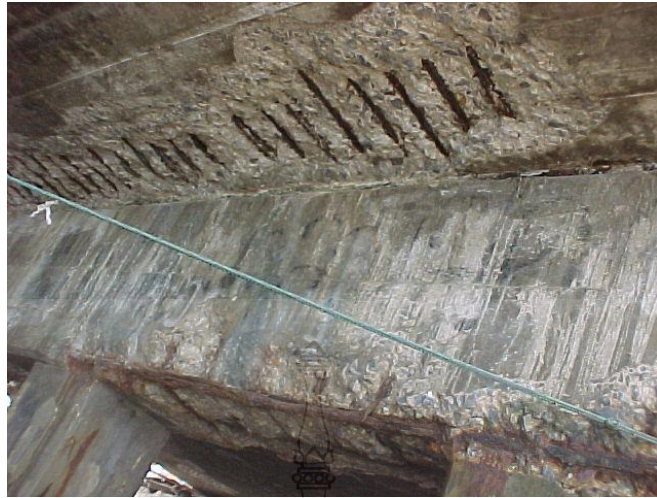
รูปที่ 2.7 ความเสียหายของพื้นและคานคอนกรีตเสริมเหล็ก เนื่องจากการเกิดสนิมของเหล็กเสริม [1]
