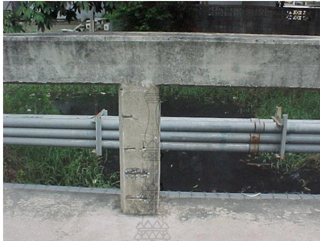
รูปที่ 2.1 ราวสะพานคอนกรีตเสริมเหล็กที่เกิดสนิมเนื่องจากคาร์บอนเนชั่น [1]
