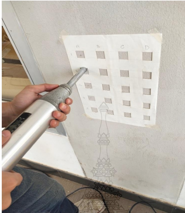
รูปผนวกที่ ข5 การทดสอบกำลังอัดประลัยของคอนกรีตด้วยค้อนกระแทก
