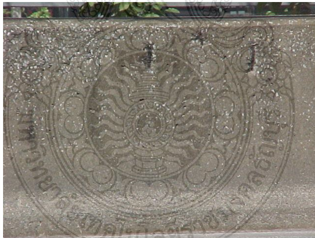
รูปที่ 2.2 แบรีเออร์คอนกรีตเสริมเหล็กที่เกิดสนิมเนื่องจากคาร์บอนเนชั่น [1]
