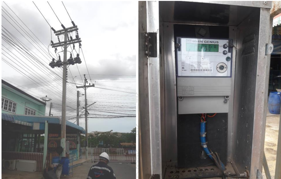
รูปที่ 3.2 เชื่อมต่อขายไฟการไฟฟ้าและเครื่องวัดขายไฟฟ้า
