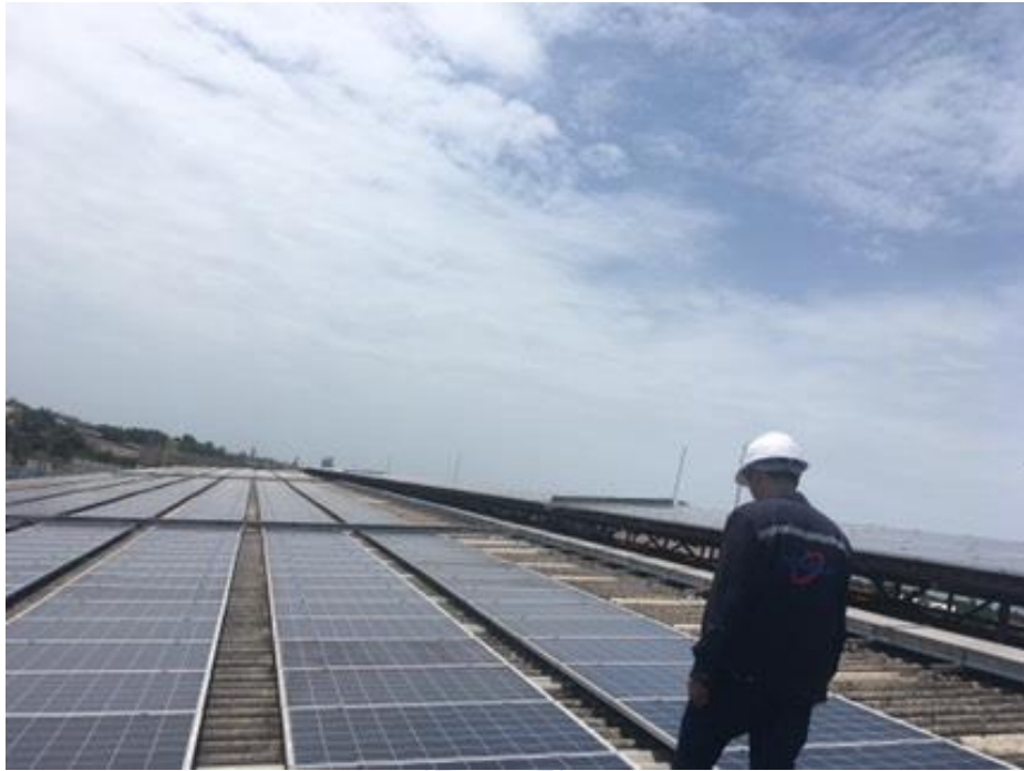
รูปที่ 3.8 แผงเซลล์แสงอาทิตย์ชนิดผลึกรวมซิลิกอนที่ติดตั้งบนหลังคา
