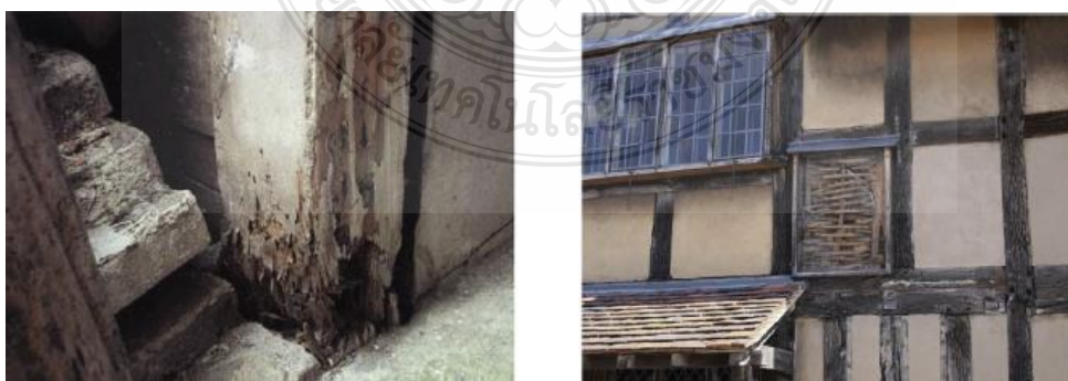
รูปที่ 2.8 แสดงการเสื่อมสภาพของเสาไม้ที่เป็นองค์อาคารในลักษณะต่างๆ[13]
