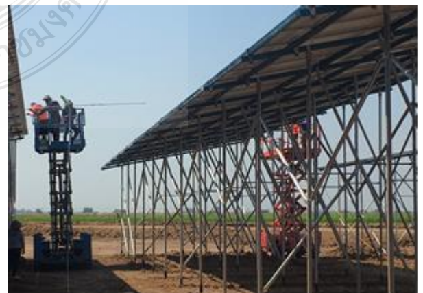
รูปที่ 3 การทดสอบลดอุณหภูมิแผงโซลาร์เซลล์ 40 แผง[4]
