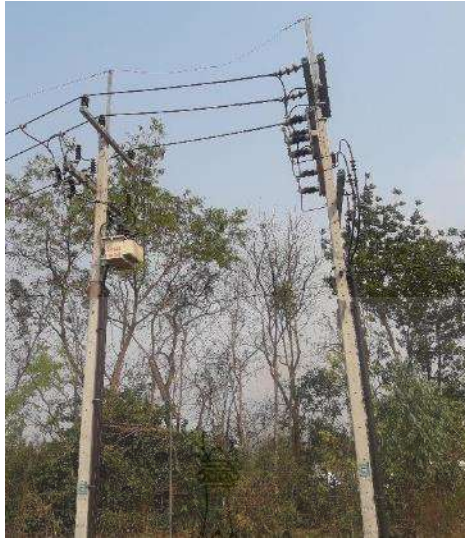
รูปที่ 3.19 หม้อแปลงไฟฟ้าสำหรับงานอำนาจการขนาดพิกัด 50 kVA 22kV/400-230V
