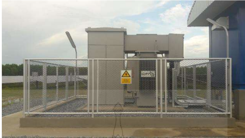
รูปที่ 2.12 หม้อแปลงไฟฟ้ากำลังแบบยกแรงดันไฟฟ้า
