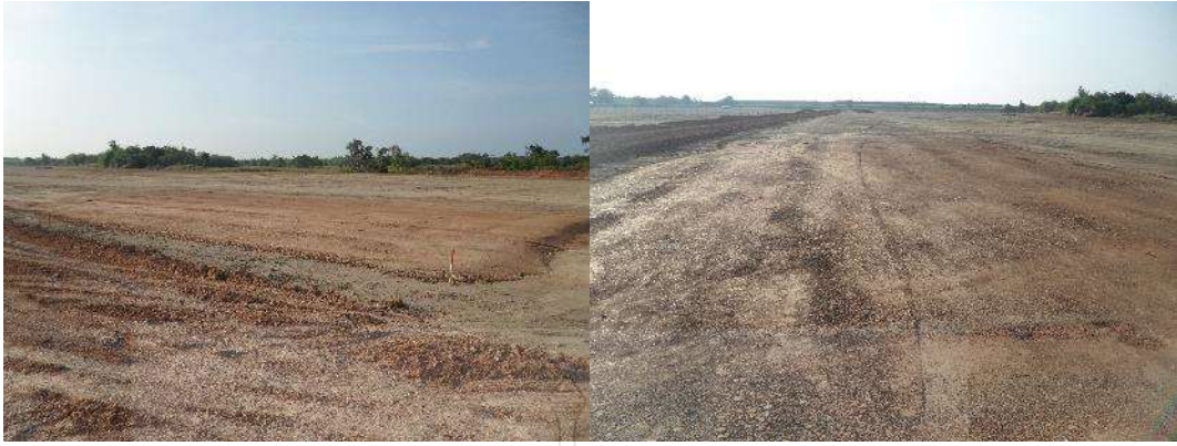
รูปที่ 3.21 การปรับพื้นที่เพื่อใช้ในการก่อสร้างโรงไฟฟ้าพลังงานแสงอาทิตย์
