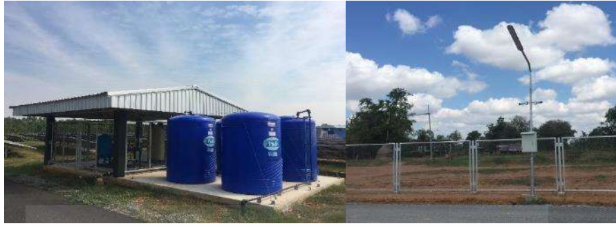
รูปที่ 2.15 ระบบน้ำในการทำความสะอาดแผง
