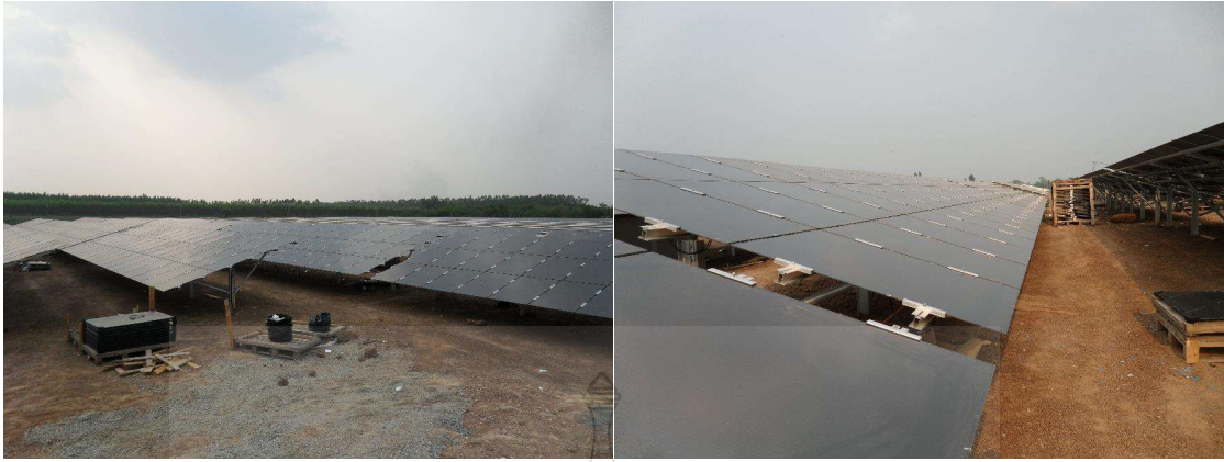
รูปที่ 3.29 แผงเซลล์แสงอาทิตย์ชนิดฟิล์มบางที่ทำการติดตั้งแล้วเสร็จ
