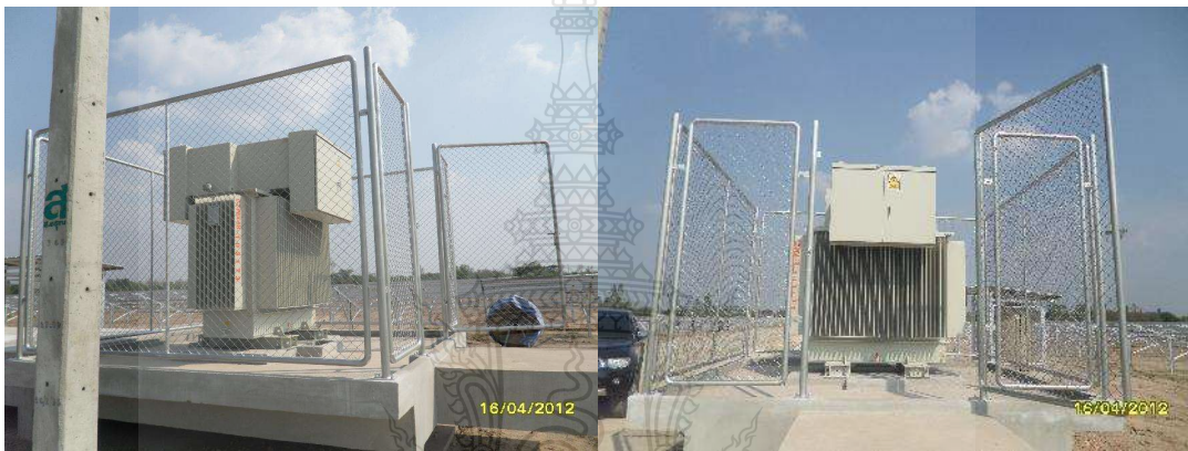
รูปที่ 3.25 หม้อแปลงไฟฟ้ากำลังที่ทำการติดตั้งบนนั่งร้าน คสล.
