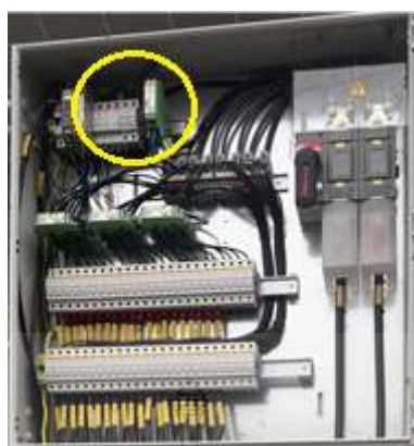
รูปที่ 2.21 อุปกรณ์ Surge Protection Device (SPD) และระบบสายกราวด์
