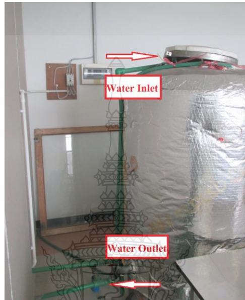
รูปที่ 3.3 ถังเก็บน้ำร้อนหุ้มฉนวนอย่างดี
