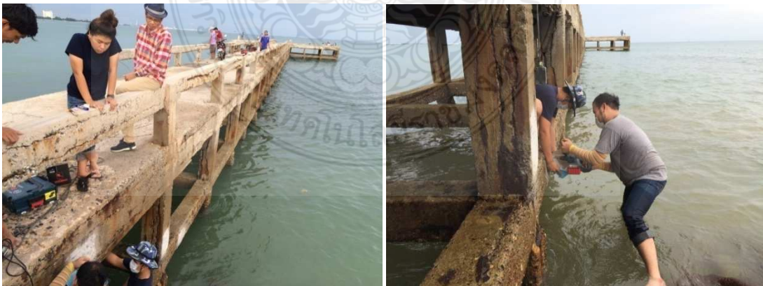
รูปที่ 3.6 ภาพถ่ายสถานที่จริงท่าเทียบเรือสะพานปลา (ตัวที่ 1) โดยทำการเก็บตัวอย่างผงคอนกรีตจากคาน เสา และราวกันตก
