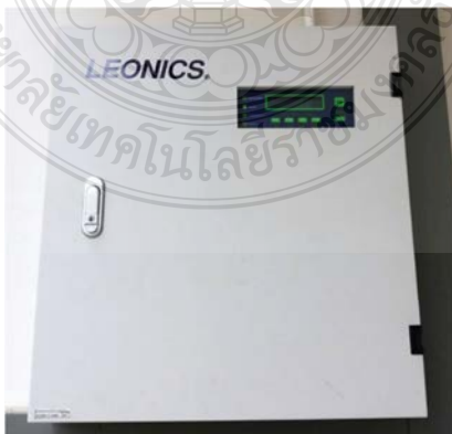
รูปที่ 3.11 อุปกรณ์ป้องกันไฟฟ้าย้อนกลับสายส่ง (Back-Feed Protection)
