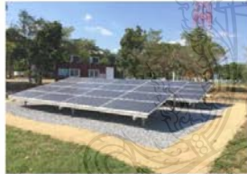
รูปที่ 2 ระบบผลิตไฟฟ้าจากเซลล์แสงอาทิตย์บนพื้นดิน
