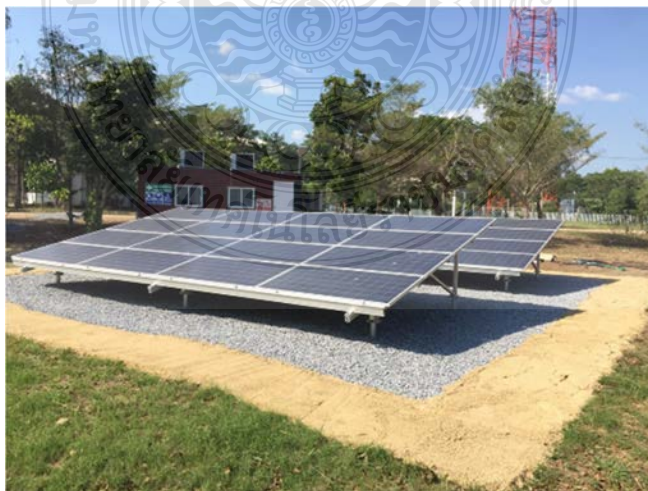
รูปที่ 3.7 แผงเซลล์แสงอาทิตย์ที่ติดตั้งบนพื้นดิน
