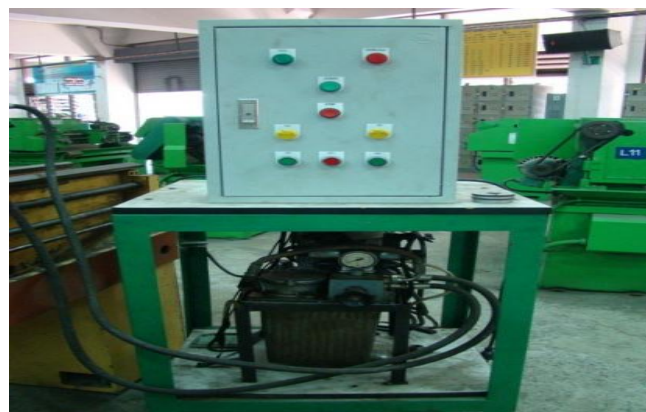
รูปที่ 3.3 อุปกรณ์ควบคุมระบบไฮดรอลิก
