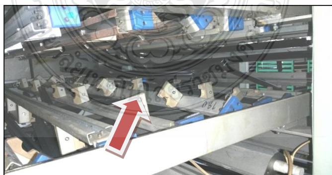
ภาพที่ 3.12 แสดงลักษณะของปัญหาชิ้นงานตกตู้ โดยที่ตัวชิ้นงานไม่ได้วางอยู่บนรางวางชิ้นงานจัด และพันกันภายในตู้อบชิ้นงาน
