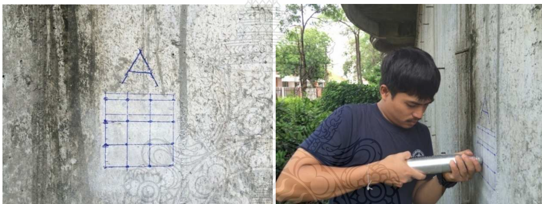
รูปที่ 3.13 การวัดค่า Rebound number ด้วยเครื่อง Schmidt hammer ที่ผิวหน้าของโครงสร้าง
