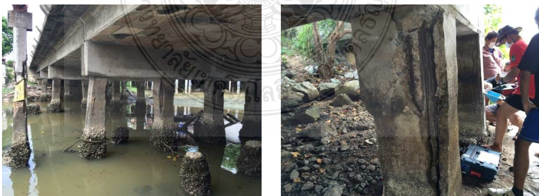
รูปที่ 2.2 ตัวอย่างความเสียหายเนื่องจากการเกิดสนิมของเหล็กเสริมในคอนกรีตเนื่องจากเกลือคลอไรด์
