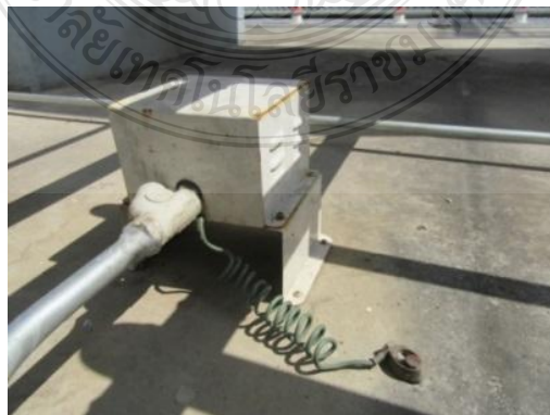
รูปที่ 3.11 อุปกรณ์สัญญาณจับก๊าซรั่ว (Gas Detection System )
