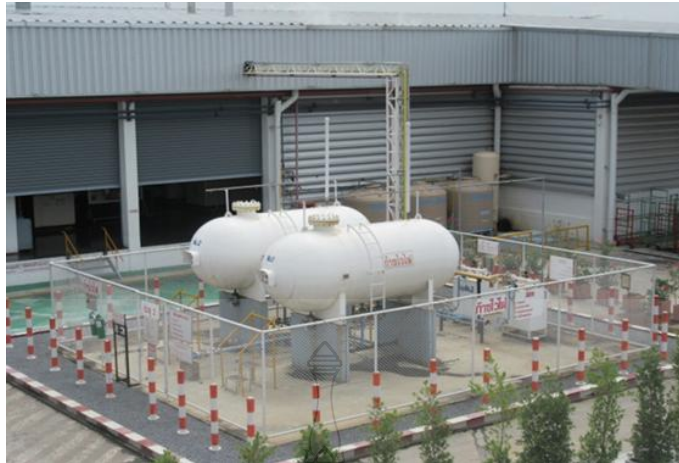
รูปที่ 1.4 สถานีกักเก็บและจ่ายก๊าซ LPG ภายในบริษัทกรณีศึกษา
