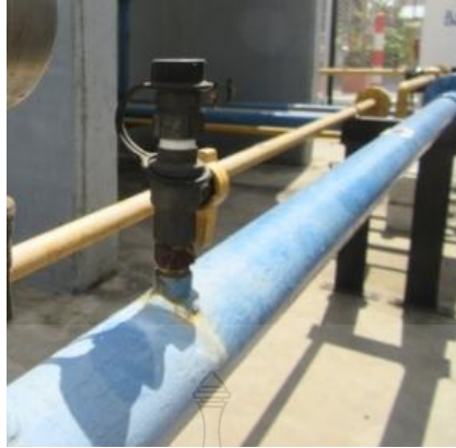
รูปที่ 3.19 กลออุปกรณ์ระบายแรงดันนิรภัย (Safety Relief Valve)
