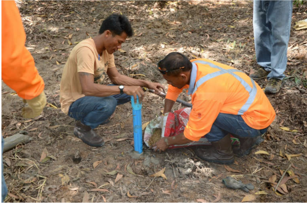
รูปที่ 3.12 แสดงติดตั้งบ่อสำรวจระดับน้ำ (Standpipe piezometer)
