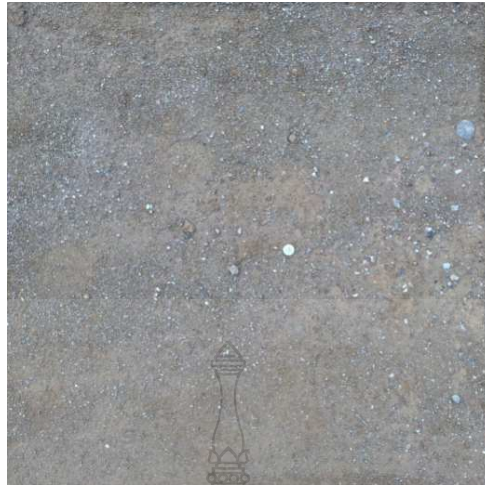
รูปที่ 4.13 สภาพผิวของชั้นพื้นทางดินซีเมนต์ที่ไม่พบรอยร้าวแบบสะท้อนในแปลงสร้างรอยร้าว
