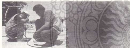
รูปที่ 6 การเจาะสำรวจหาความหนาชั้นทางถนนคอนกรีตสายทาง SN ด้วยเครื่องมือ Bore Scope
