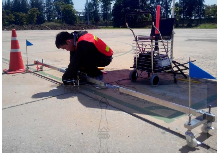
รูปที่ 3.5 เตรียมอุปกรณ์และติดตั้งเครื่อง port-LTE
