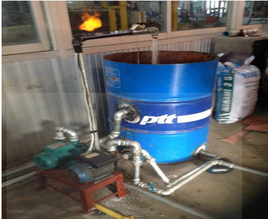
ภาพที่ ก.7 การทำงานของชุดควบคุมอัตราการไหลของน้ำ
