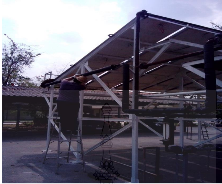
รูปที่ ข.5 วางระบบท่อส่งสารตัวนำ และหุ้มฉนวน (20 มกราคม 2557)
