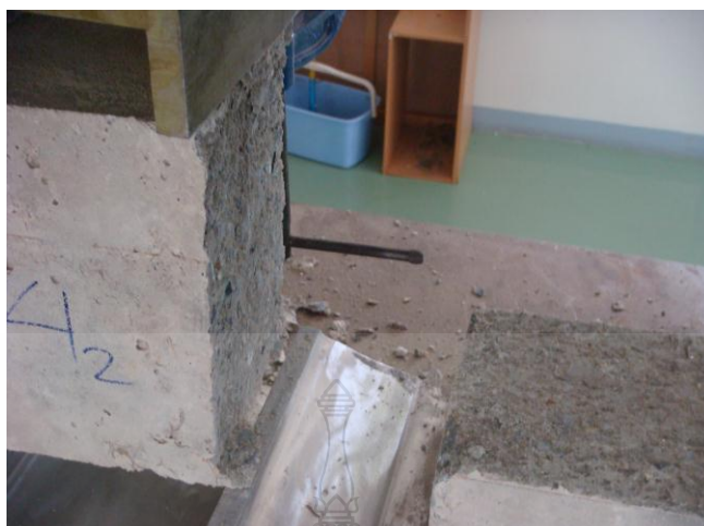
ภาพที่ 4.2 เทคอนกรีตไม่ต่อเนื่อง (มีรอยต่อ)
