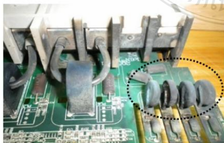
รูปที่ 4 วาริเตอร์ภายในมีเตอร์ AMR ที่ได้รับความเสียหาย
