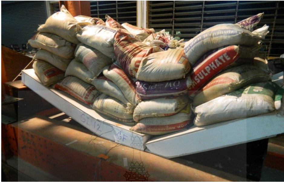
รูปที่ ก.17 แผ่นพื้น GF-14-FT หลังจากใส่ถุงทรายชั้นที่ 4 ประมาณ 9 นาทีเกิด การวิบัติของแผ่นพื้น
