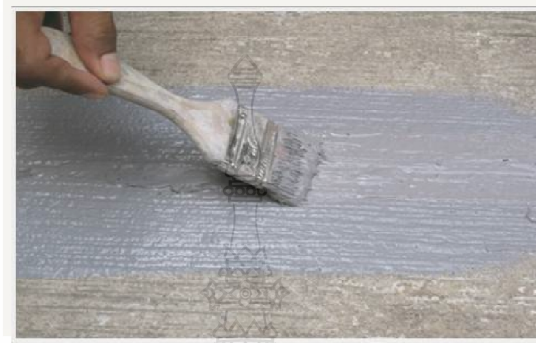
รูปที่ 2.14 การทาสารยับยั้งการเกิดสนิมที่พื้นผิวคอนกรีต
