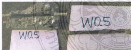
(ก) เหล็กในตัวอย่างคอนกรีตที่เกิดสนิมแล้ว
