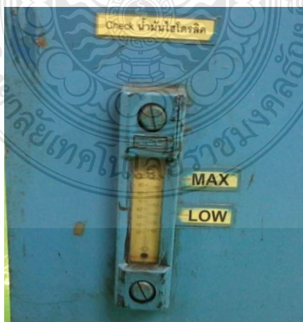
รูปที่ 2.2 การตรวจสอบระดับน้ำมันไฮดรอลิก
