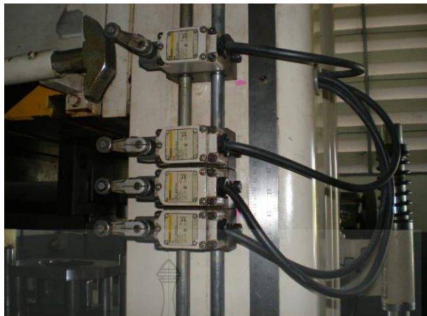
รูปที่ 3.18 การปรับตั้ง (Limit switch) เครื่องปั๊ม
