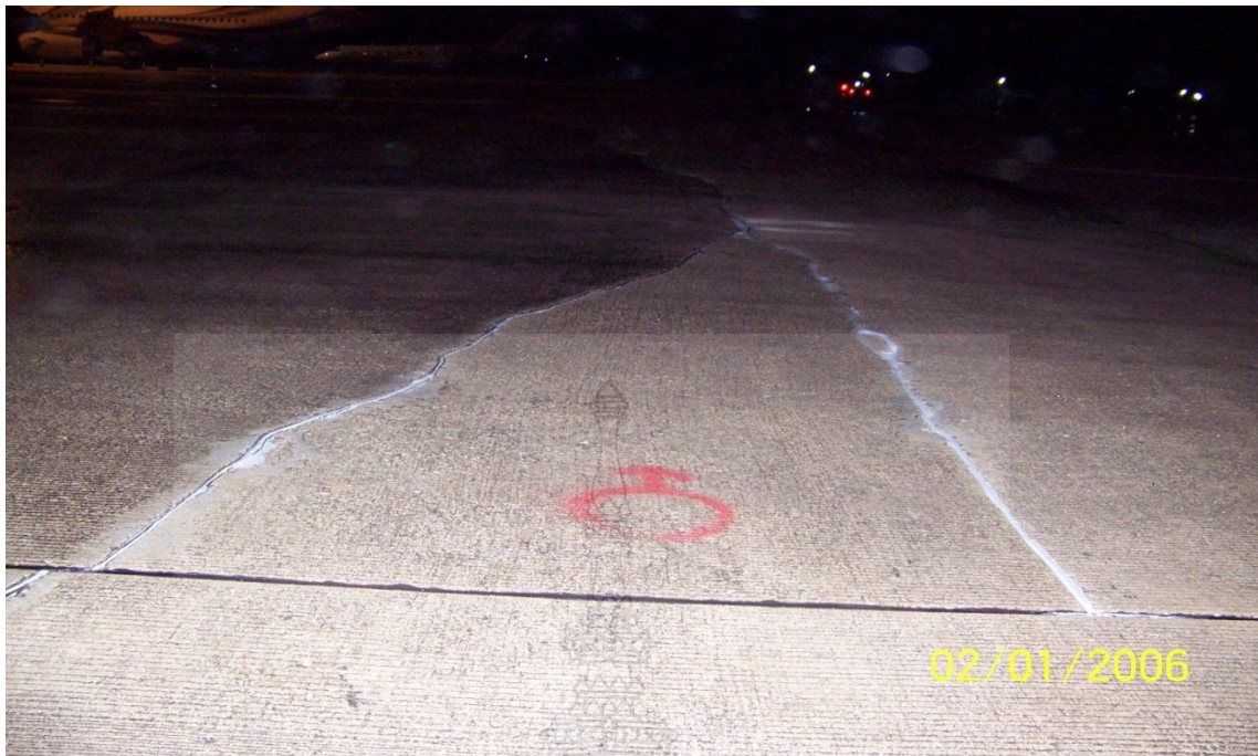
ภาพที่ ข.1 ภาพความเสียหายของแผ่นพื้นคอนกรีตของทางขับ B (Taxiway B) แนวทดสอบที่ 1 สถานีทดสอบ 0+100 ท่าอากาศยานนานาชาติภูเก็ต
