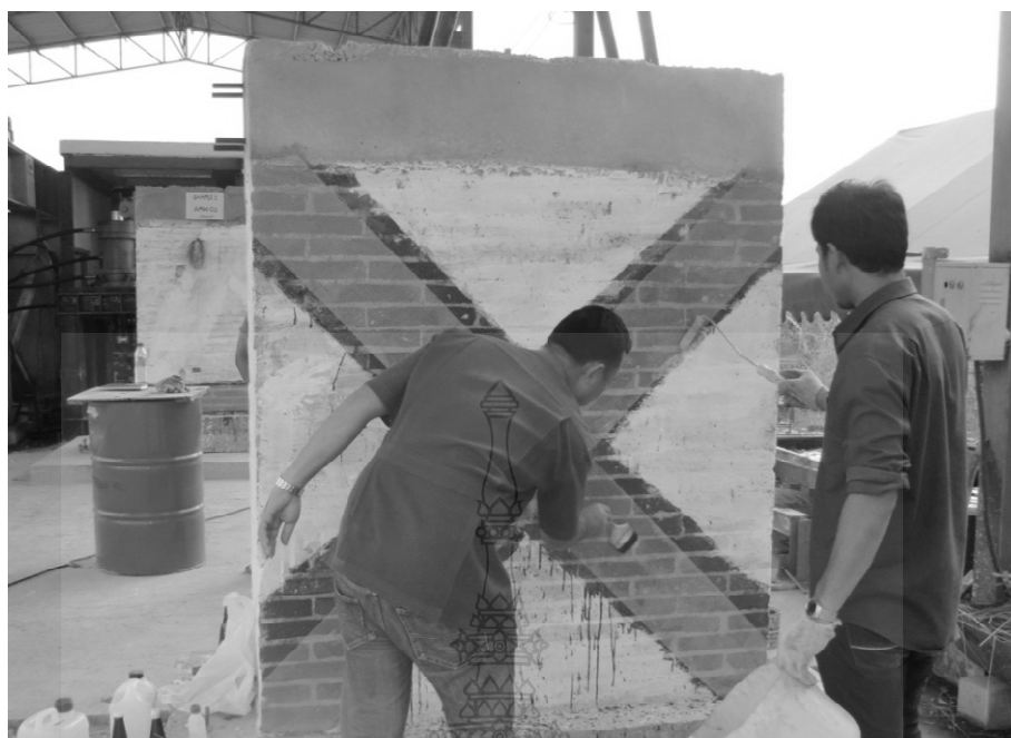
ภาพที่ ก.25 การติดตั้งเส้นใยไฟเบอร์ (ต่อ)
