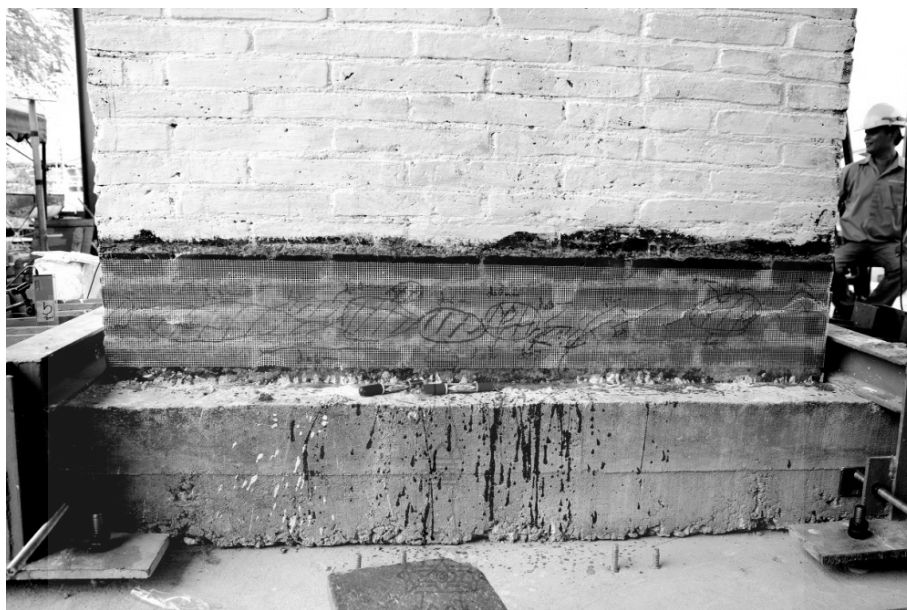
ภาพที่ ก.38 จากการทดสอบผนัง AMW01_GFRP.A บริเวณที่ซ่อมแซมรอยแตกร้าว GFRP เกิดการ ฉีกขาดและหลุดร่อน
