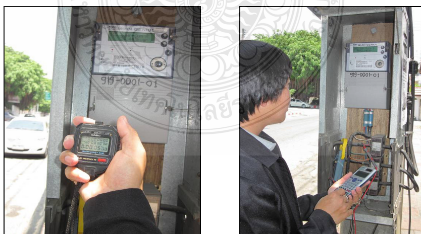
ภาพที่ 3.18 การวัดค่าเวลาและคำนวณค่ากำลังไฟฟ้าจริงจาก LED1
