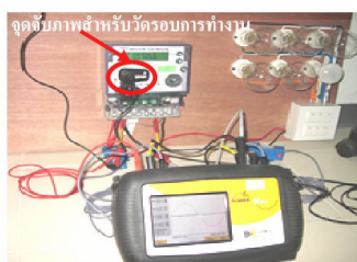
รูปที่ 4 การตรวจสอบเครื่องวัดพลังงานไฟฟ้าแบบอิเล็กทรอนิกส์
