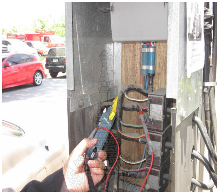
ภาพที่ 3.17 การวัดกำลังไฟฟ้าจริงด้วยแคล้มป์ออนเพาเวอร์มิเตอร์
