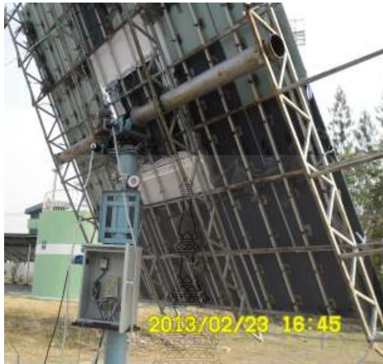
รูปที่ 4.4 การต่อ สเต็ปป์มอเตอร์ควบคุมแผงสะท้อนรังสี
