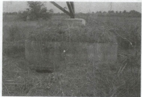
รูปที่ 11 ดินบริเวณฐานรากเกิดการทรุดตัวมาก
