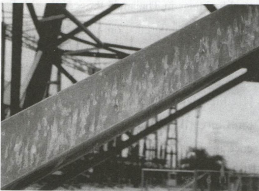
รูปที่ 16 มูลนกที่ถูกถ่ายทิ้งสะสมไว้บนชิ้นส่วนเสาไฟฟ้า
