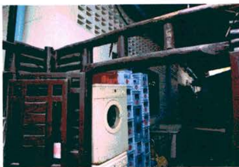
ภาพที่ 3.15 แสดงห้องเครื่องงานระบบ
