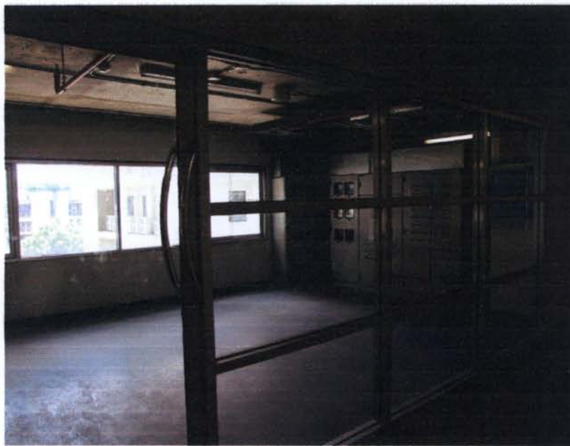
ภาพที่ 3.26 แสดงห้องเครื่องระบบไฟฟ้า
