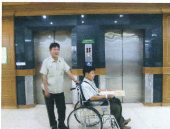
ภาพที่ 3.39 แสดงงานระบบลิฟต์
