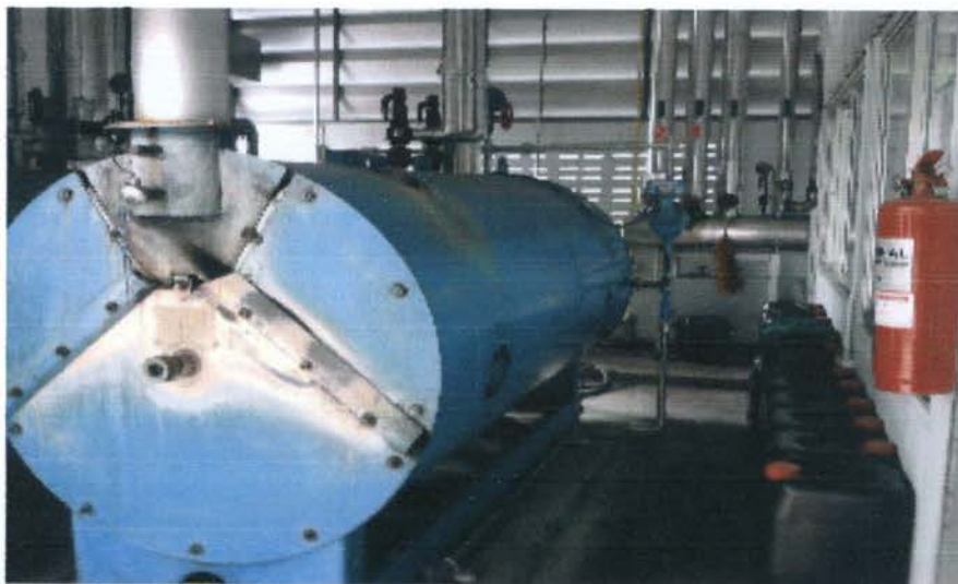
ภาพที่ 3.35 เครื่องกำเนิดไอน้ำ
