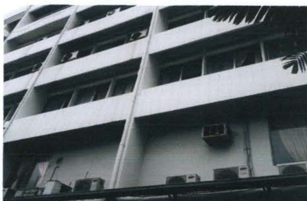
ภาพที่ 3.40 แสดงงานระบบปรับอากาศ
