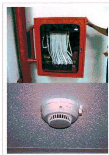
ภาพที่ 3.20 แสดงตู้เก็บสายฉีดน้ำดับเพลิงและ ระบบดับเพลิงแบบโปรยน้ำเป็นฝอย
