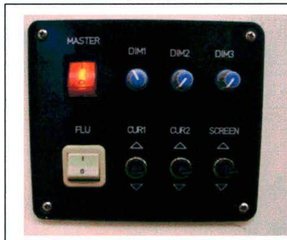
ภาพที่ 2.42 ภาพ Switch Board Control
