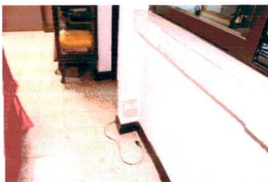
ภาพที่ 3.15 ภาพแสดงงานระบบไฟฟ้า
