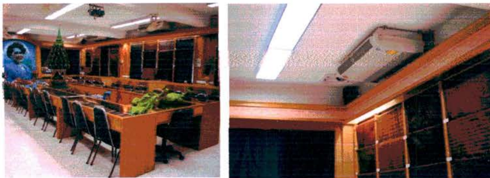
ภาพที่ 3.17 ภาพแสดงงานระบบปรับอากาศ
